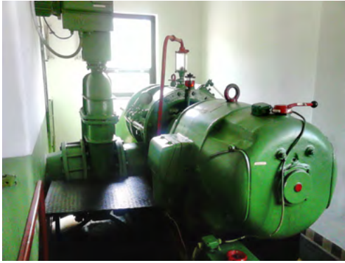
Kölked szvtp. felújított szivattyú
