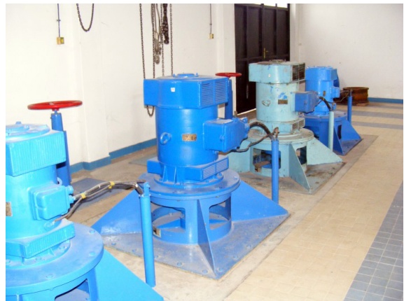
Ordacsehi szivattyútelep - szivattyúk
