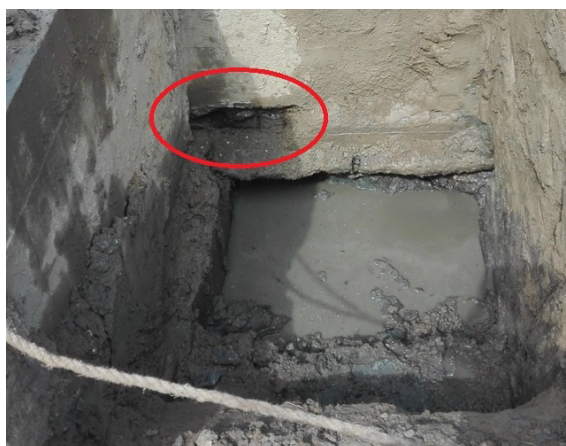
6. ábra A Gréda-Lugi zsilip mentett oldali zsilipakna oldalfal rossz minőségű beton feltárása
