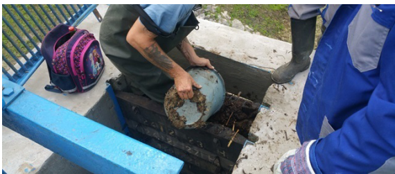
3. ábra A Gréda-Lugi zsilip hullámtéri zsilipakna ideiglenes elzárása
