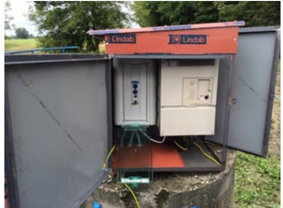
Gordisai szivattyútelep inverter kiépítése után
