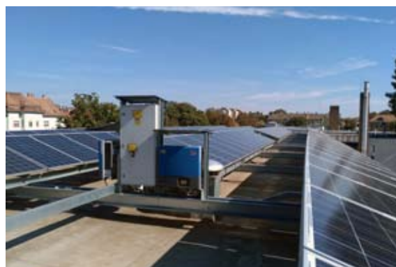
Napelemek a központi épület tetején
