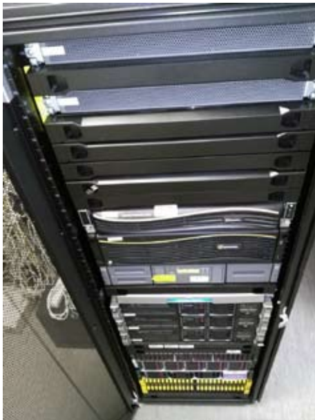
DDVIZIG központ fő rack szekrénye
