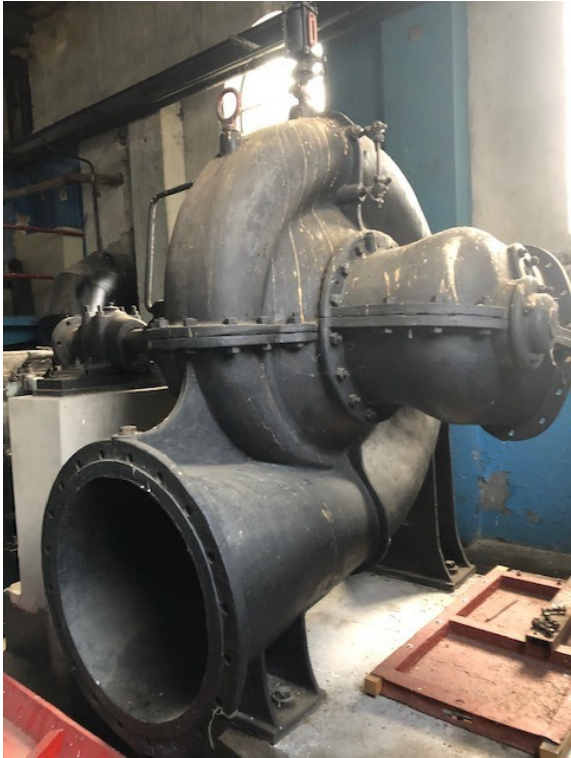
3. sz. kép: Szivattyú
