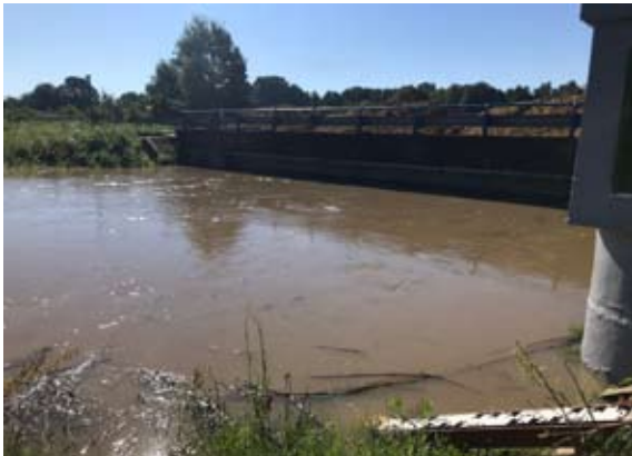
Babócsa, közúti híd – vízmérce I-II.
