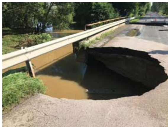
Segesd, 07. 26. – beszakadt híd
