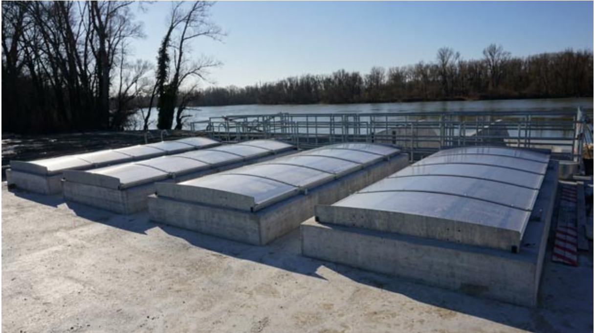
Gépleadó nyílások a gépház tetején
