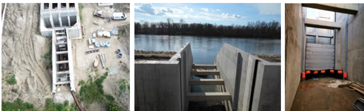
Bevezető csatorna és szívómedence
