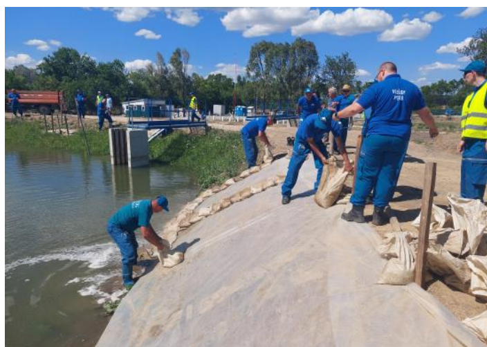
Hullámverés és szivattyúállás
