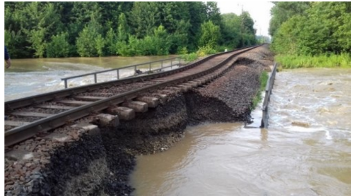
5. fénykép. Az alámosott vasúti híd Ötvöskőnyi és Beleg között Forrás: Irodalomjegyzékben
