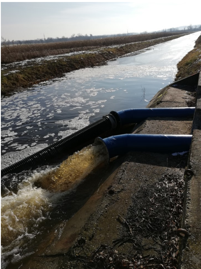
A Zamárdi szivattyútelepen a vizek átemelése a Balatonendrédi-vízfolyásba
