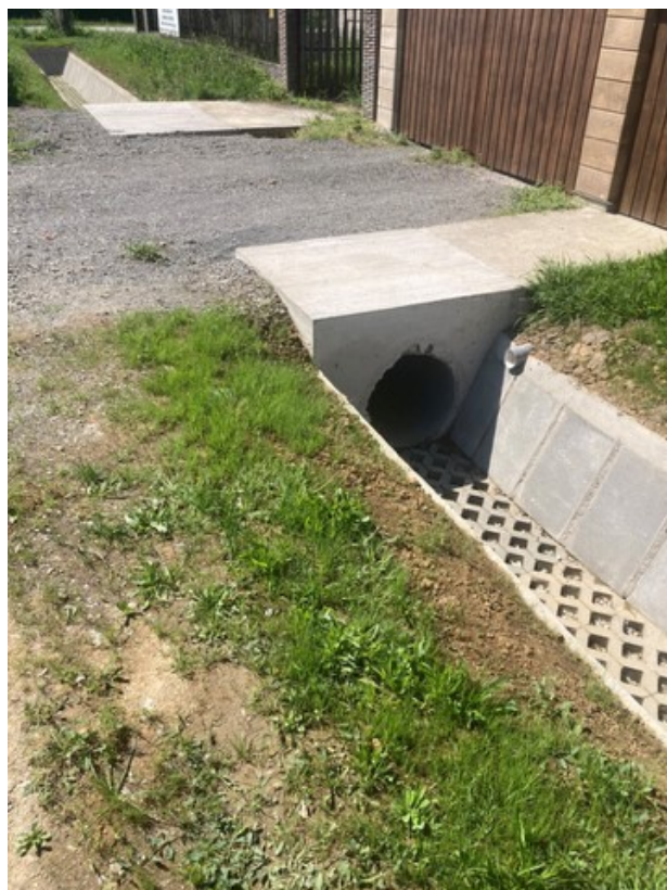
Sásd, Újtelep csapadékvíz elvezetés, beszivárogtatással
